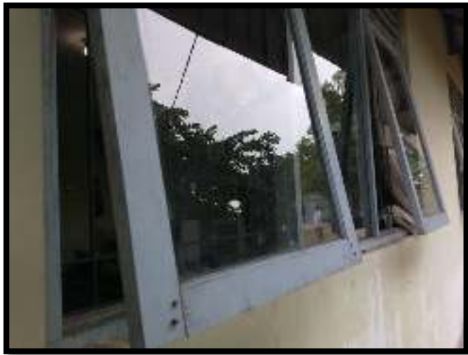
Kusen Jendela yang Tidak Lagi Kokoh
