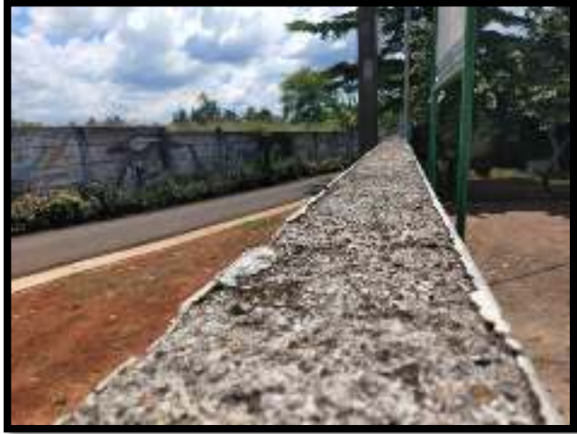
Bagian Atas Dinding Pagar yang Sudah Keropos. Rentan oleh Rembesan Air.
