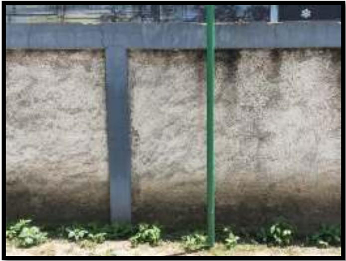
Bagian Pagar yang Tidak Tercat
