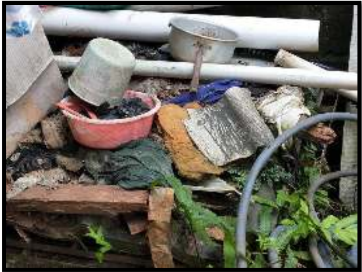
Sumur Resapan yang sudah tidak berfungsi dan tidak mampu menampung air pembuangan dalam jumlah besar. Bagian atas ditutup dan tertumpuk oleh barang bekas.
